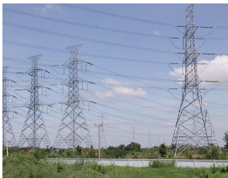
เสาไฟฟ้า
