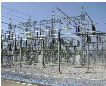
ลานไฟฟ้า
